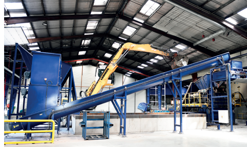
CSE - Préparation de déchets en vue de leur valorisation énergétique (produit à partir de Déchets Dangereux)
